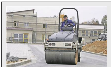
Langsam drückt die Planierdraupe den frischen Asphalt platt. Die Zufahrt zur neu gebauten Kita „Pfiffikus“ in Neustadt ist damit fast fertig. Foto: Dirk Zschiedrich
